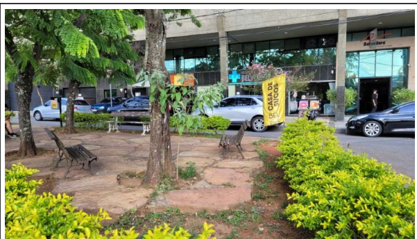
Foto 02: Piso irregular e trepidante no interior da praça
