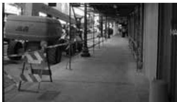
Toda obra de remodelación o construcción debe mantener un sector de circulación peatonal despejado y protegido. El ancho debe permitir el paso a una silla de ruedas.
