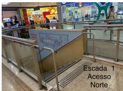
Foto 3: Guarda-corpo escada 1 de acesso à Plataforma Norte
