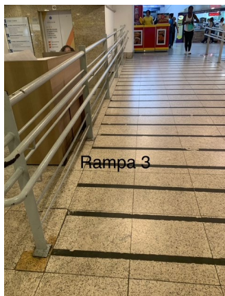
Foto 6: Rampa 3 sem guia de balizamento no desnível
