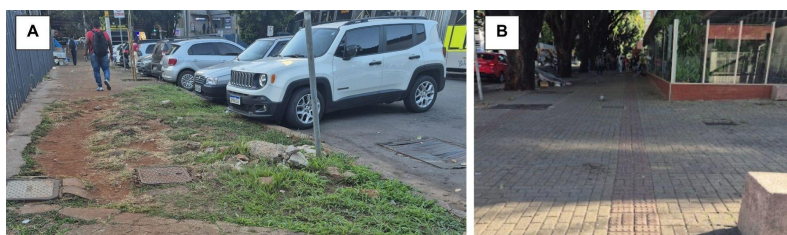
Figura 2: Calçada com pavimentação comprometida (Segmento 5) (A); Piso tátil fora das normas (Segmento 8) (B).
