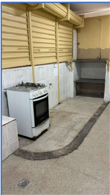
Desnível dentro da cozinha Fonte: do autor
