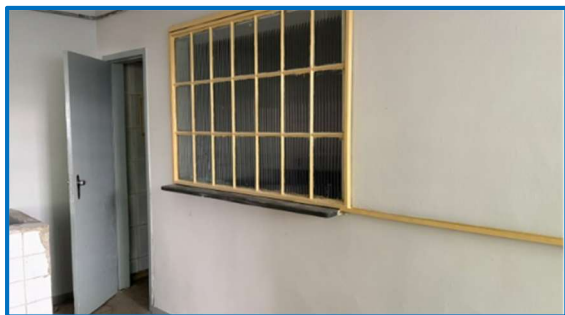
Altura da janela fora da faixa de alcance visual Fonte: do autor
