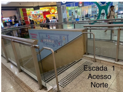
Foto 3: Guarda-corpo escada 1 de acesso à Plataforma Norte
