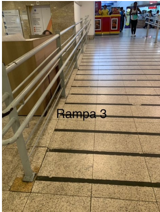
Foto 6: Rampa 3 sem guia de balizamento no desnível
